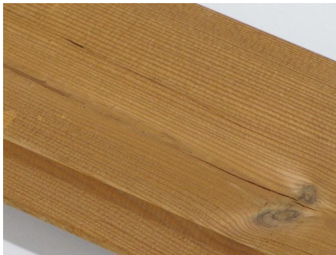
Dopuszczalne są nieznaczne pęknięcia na krawędziach.
